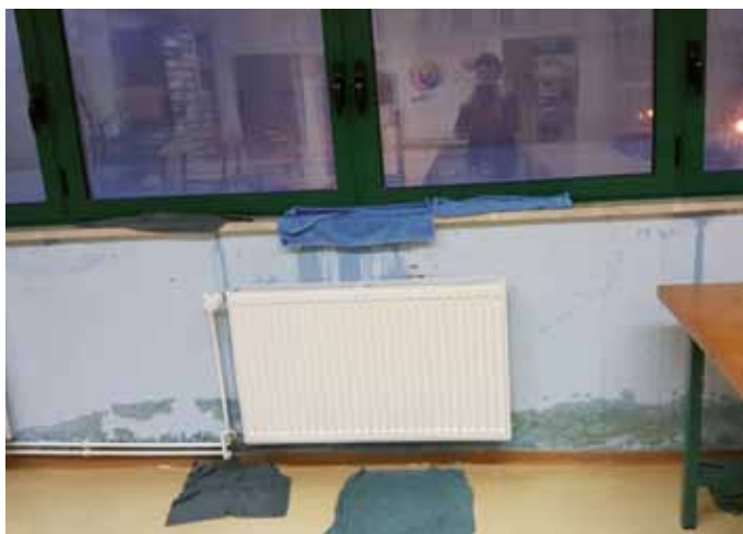
ISOLA: una delle classi danneggiate della Scuola elementare Dante Alighieri
